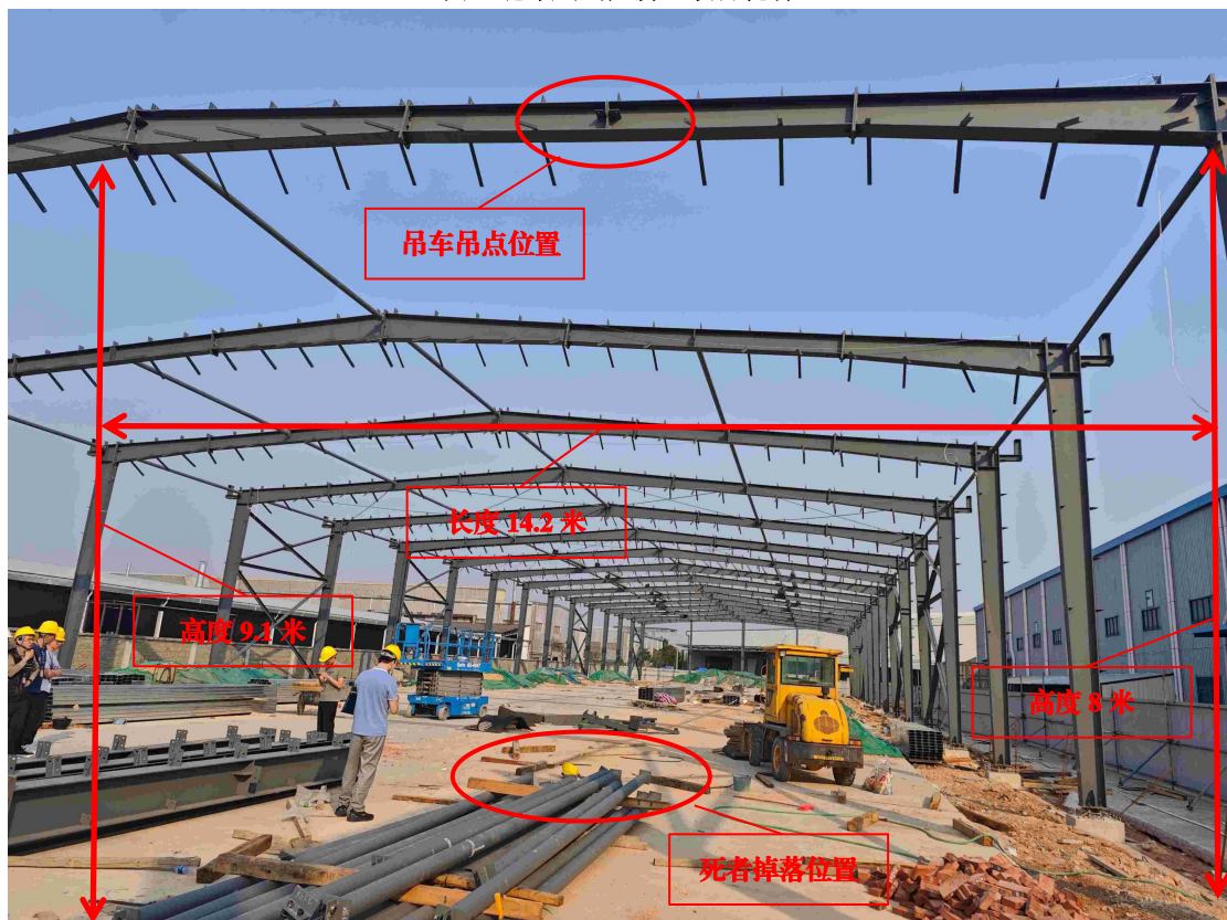
图 2 事故发生现场情况
