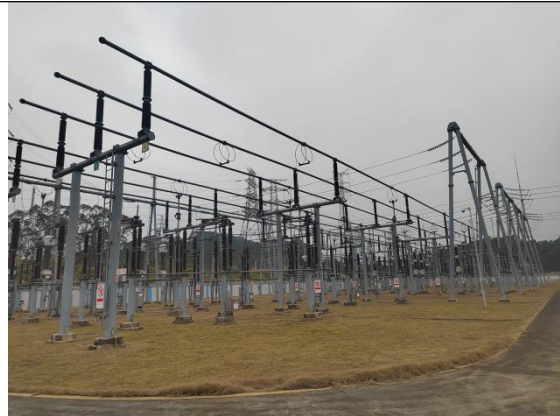
220kV 配电装置场地
