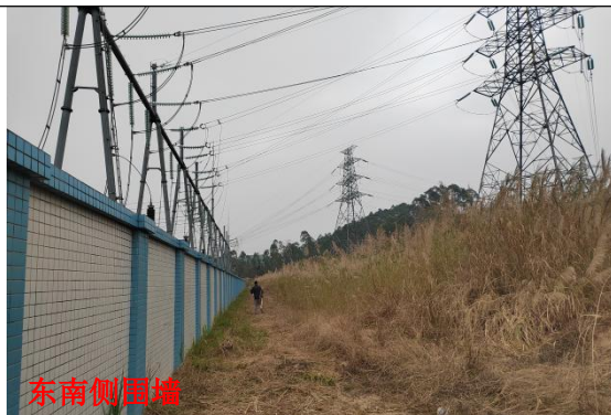
变电站东南侧
