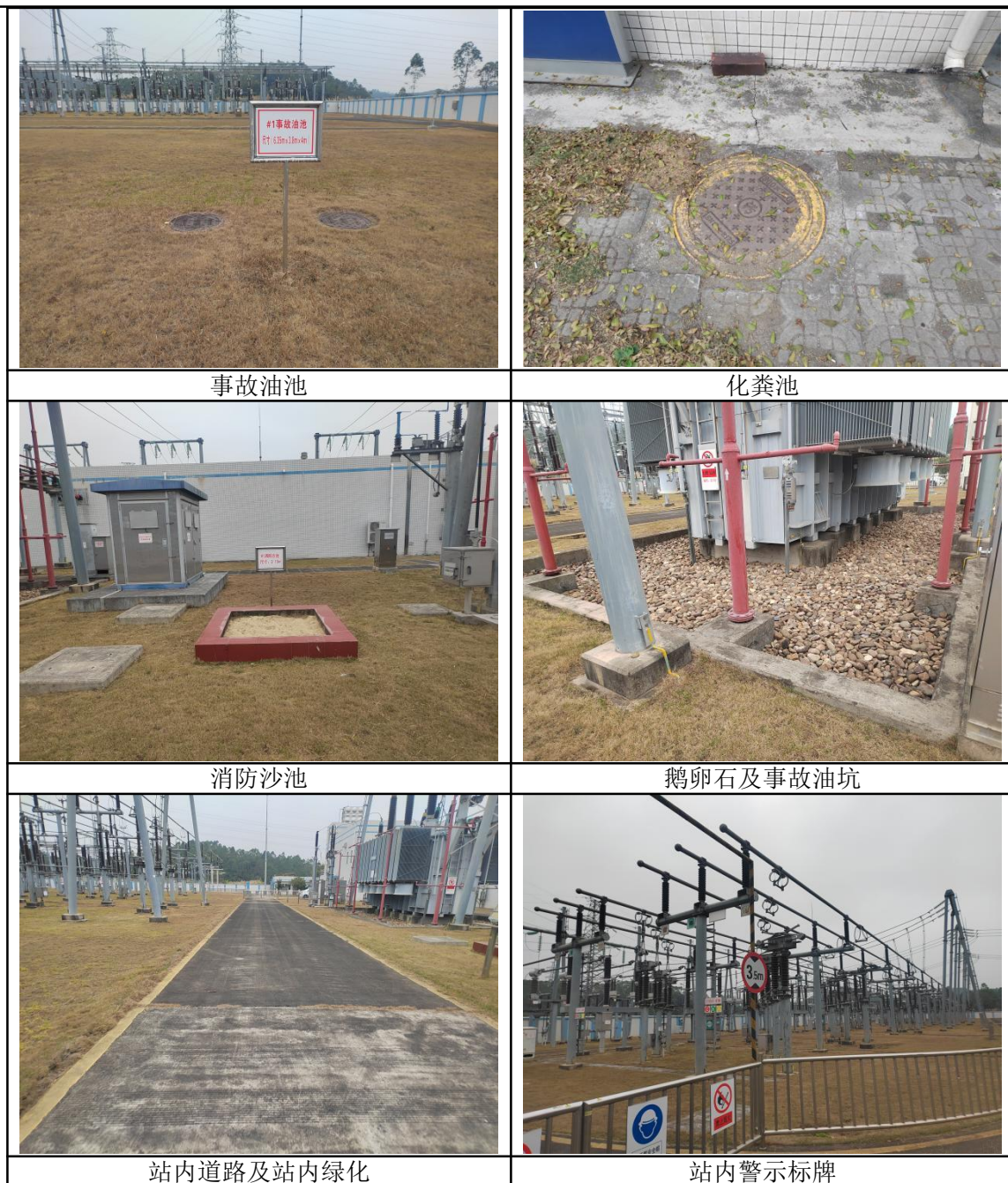
图 3-5 220kV 彩虹站站环保设施现状图
