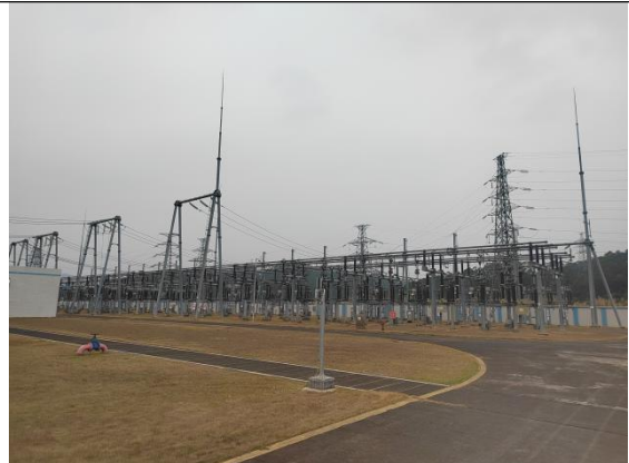
110kV 配电装置场地
