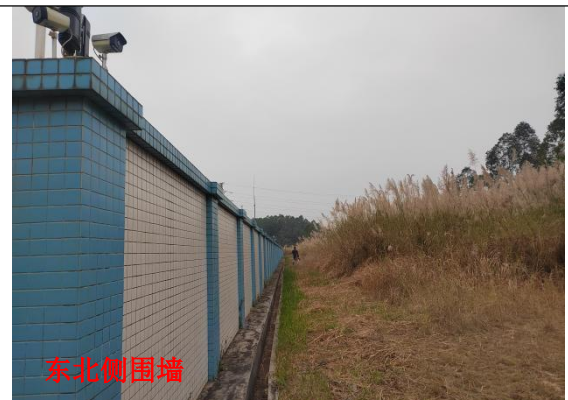
变电站东北侧
